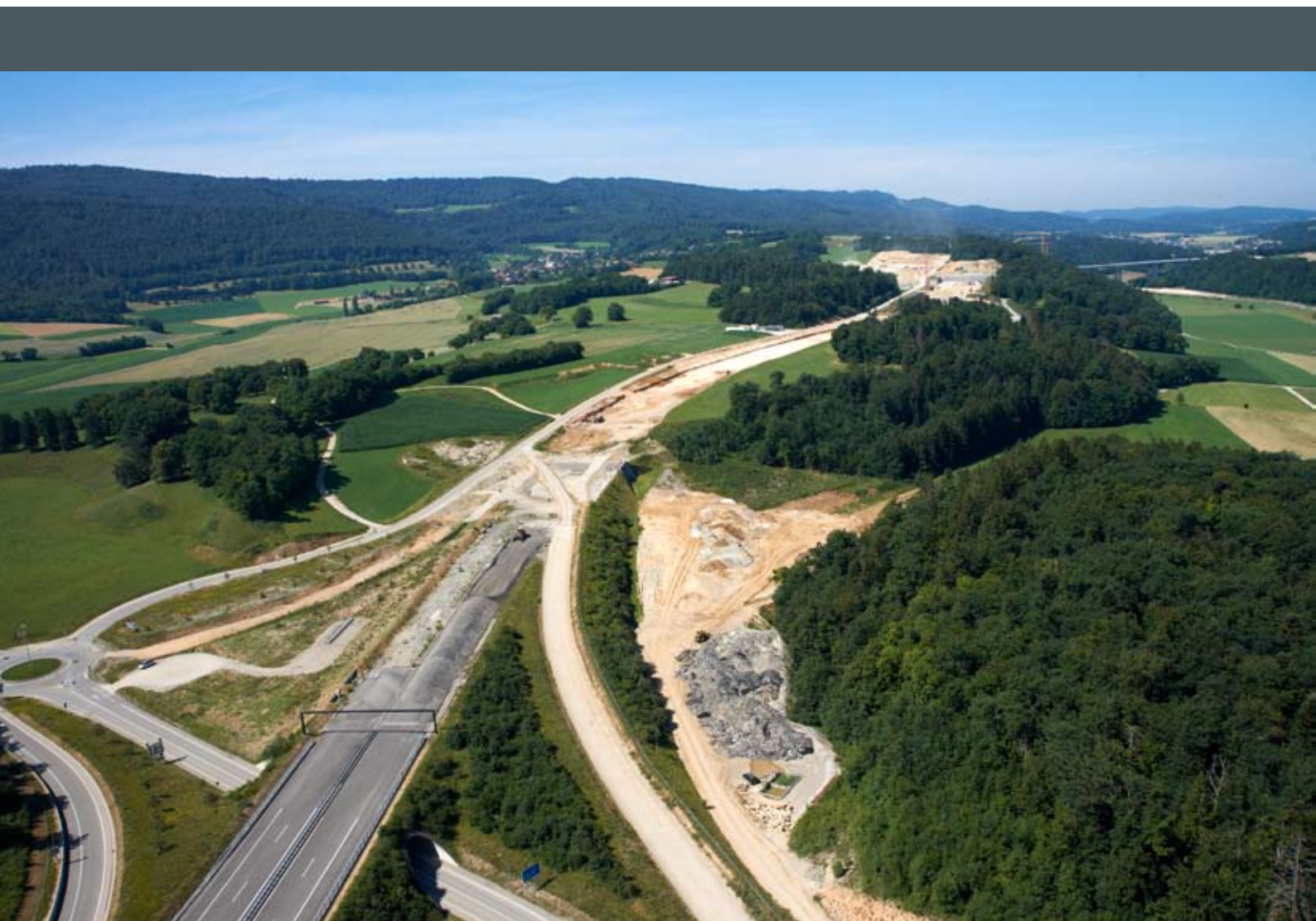
La construction des infrastructures du secteur situé entre la jonction de Porrentruy Ouest et les tunnels du Bois de Montaigne fait l'objet d'un recours avec effet suspensif. Photo: F.Enard, 4.07.2011.
